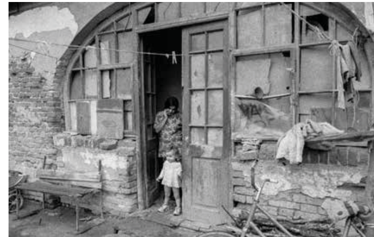
Das Haus war nicht unterkellert. Der Lehm, auf dem das Gebäude stand, war in vielen Zimmern zugleich der Fußboden. Die Nässe war über das beschädigte Dach und den nackten Boden in die Mauern eingedrungen. An den Wänden wuchs Schimmel. Es war feucht und kalt.
